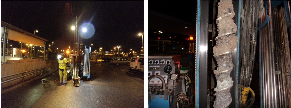
Figur 4. Provpunkter norr om Expressgodshuset (provpunkterna 10, 11 och 14). Här noterades lukt av kresot.
